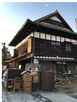
写真10 片付けが始まった頃の東側外観
