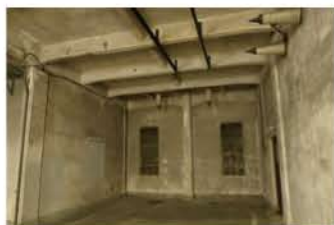
変電所内部の大空間
