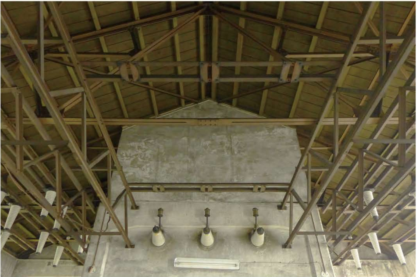
旧湘南電鉄瀬戸変電所内部。碓子が見える（写真 米山淳一）
