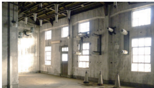
旧湘南電鉄瀬戸変電所内部
