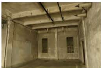
変電所内部の大空間
