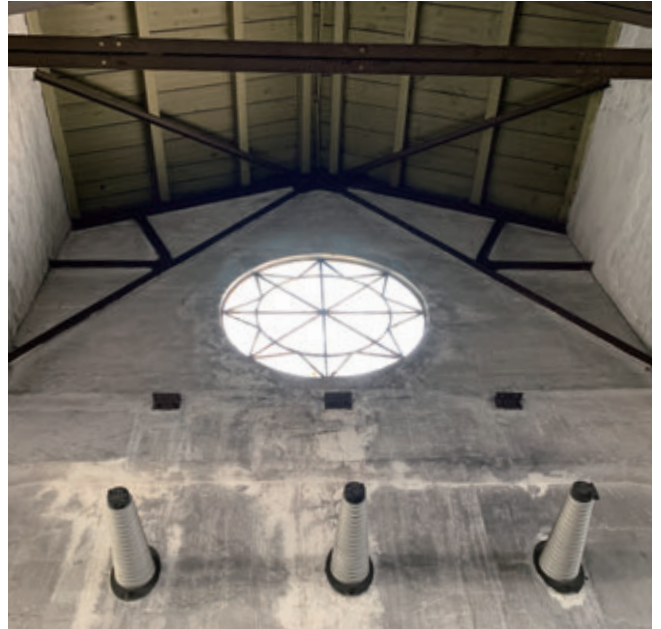
瀬戸変電所内観。当時のガイシやバラ窓が目を引く
